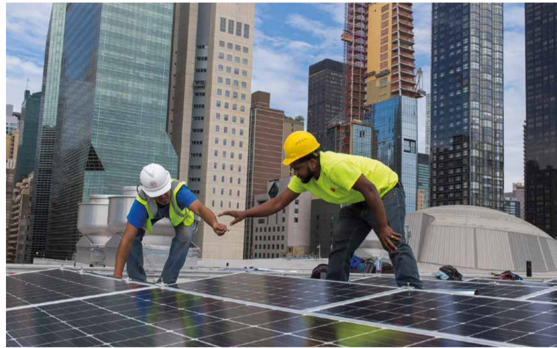
Installation von Solarkollektoren auf dem Dach der Vereinten Nationen in New York. Foto: UN Photo/Mark Garten
