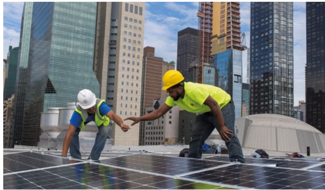
Installation von Solarkollektoren auf dem Dach der Vereinten Nationen in New York. (UN Photo/Mark Garten)
